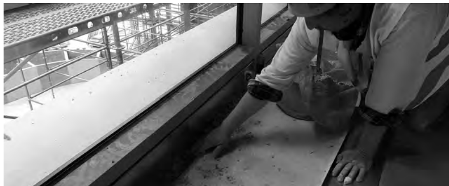
Figure 5.11 : Remplissage de l'espace compris entre la tôle 'pare-flamme' et le plancher de compartimentage au moyen de laine de roche afin d'obtenir une obturation d'une classe de résistance au feu EI 60.
