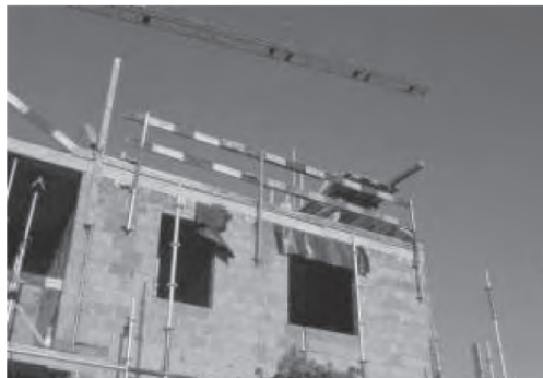
Figure 13.7 : Exemple de la mauvaise pose des membranes.
