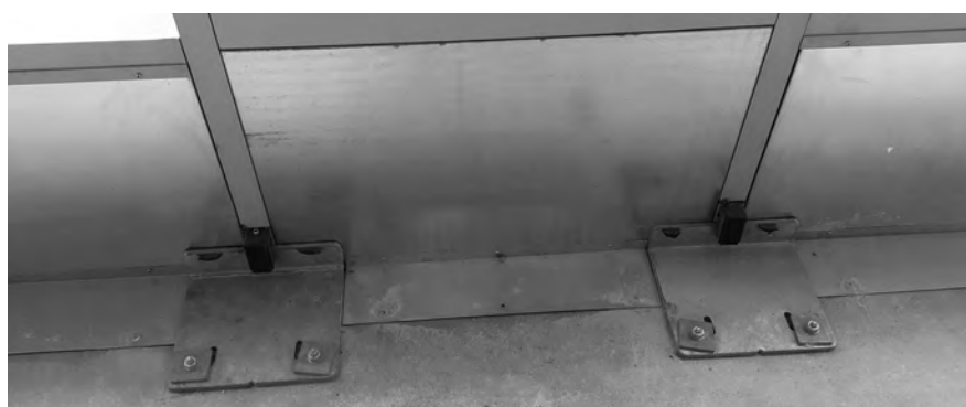
Figure 5.12 : Fixation d'une tôle supérieure discontinue et sans recouvrement au niveau des ancrages. La continuité horizontale de la tôle 'pare-flamme' est assurée par un renfort en acier dans le montant en aluminium de la façade.
